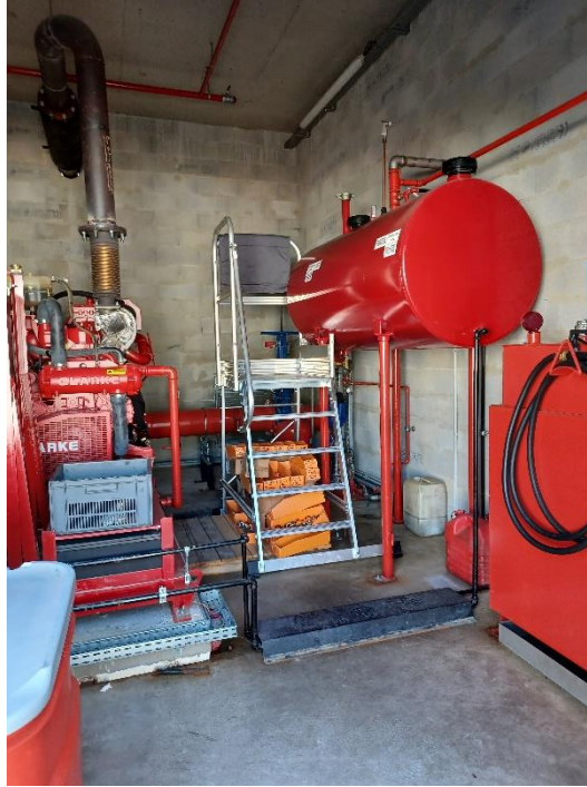
Cuve de fioul dans local sprinkler
